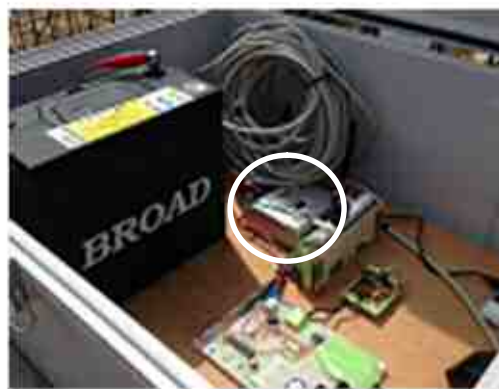
図3. 制御回路（蓄電池，Wi-Fiルーター）
